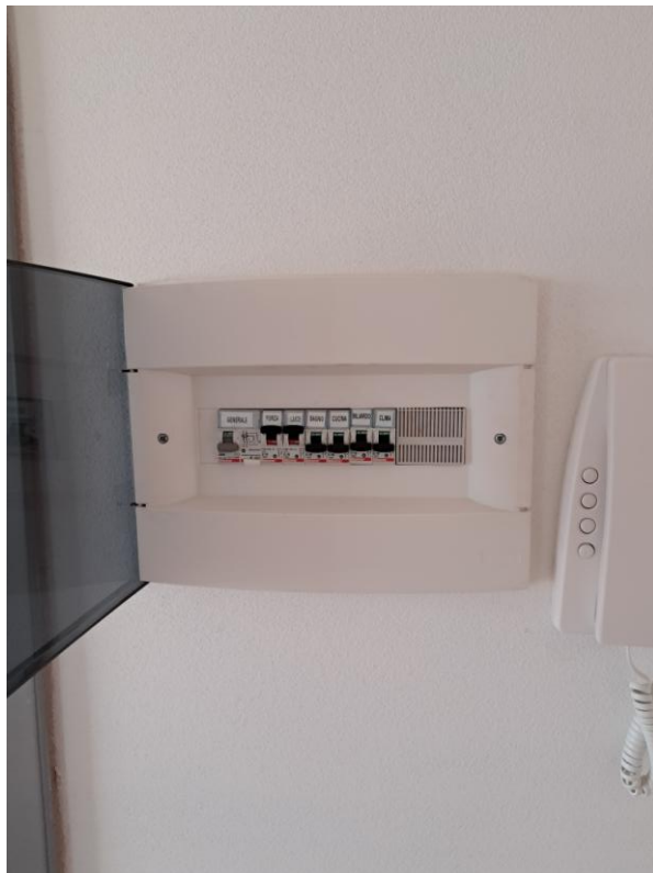
Foto 9: ufficio sub 31- Quadro elettrico
